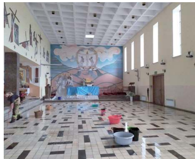
Po zerwaniu dachu wnętrza kościoła zostało zalane, strażacy cały czas zbierali wodę
