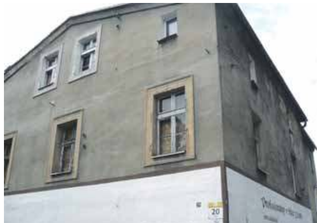
Zabytek przy ul. T. Królika 20 jest bardzo zniszczony i wymaga generalnego remontu
