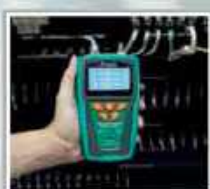
pomiar długości przewodu; lokalizacja punktu przzerwania
