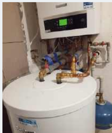
📍 Wiszący kondensacyjny kocioł i stojący zasobnik 120 l ulokowano w kotłowni.
