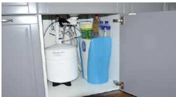
➔ Stacja odwróconej osmozy zamontowana w szafce pod zlewozmywakiem. L. JAMPOLSKA
