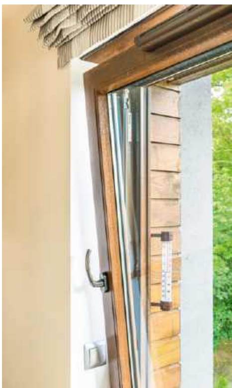
📌 Nowe domy są szczelne, więc niezbędnym elementem systemu wentylacji grawitacyjnej stały się w nich nawiewniki, montowane np. w górnej części okna. KRISHOME
