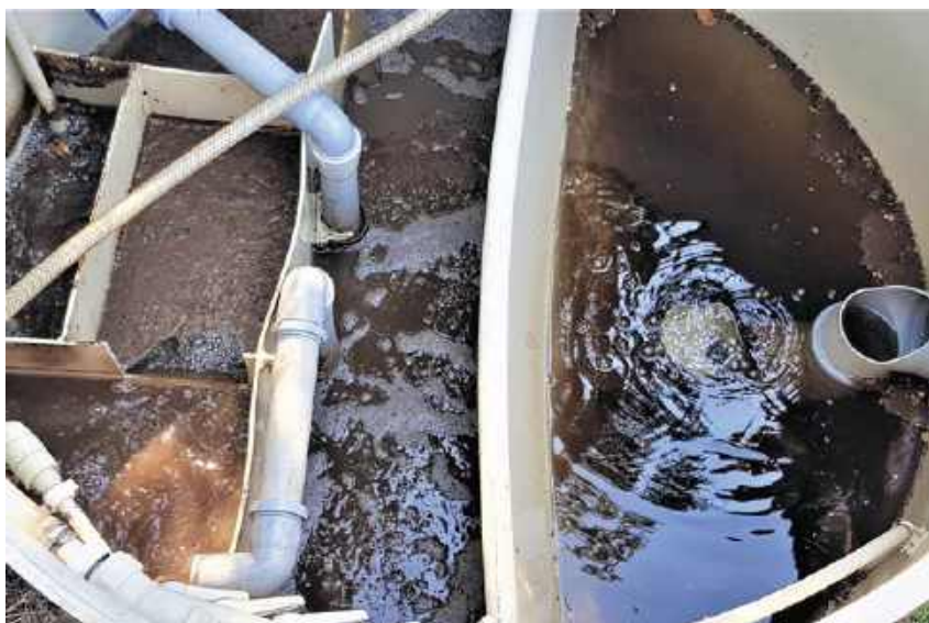
📍 Wnętrze oczyszczalni biologicznej. EKO HOUSE TECHNOLOGIE EKOLOGICZNE
