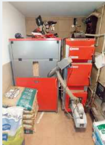
W dużej kotłowni umieszczono kocioł n.p.s. z zapasem peletów.
