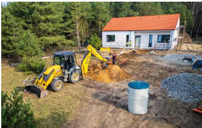
📍 Oczyszczalnia jest droższa od szamba na etapie budowy i dużo tańsza w eksploatacji. EKO HOUSE TECHNOLOGIE EKOLOGICZNE
