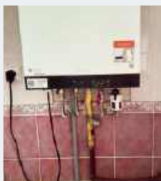
Do regulacji trybów i temperatury wody wykorzystuje się tylko regulator na kotle.
