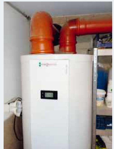
Powietrzną pompę ciepła przeznaczono do przygotowywania c.w.u.
