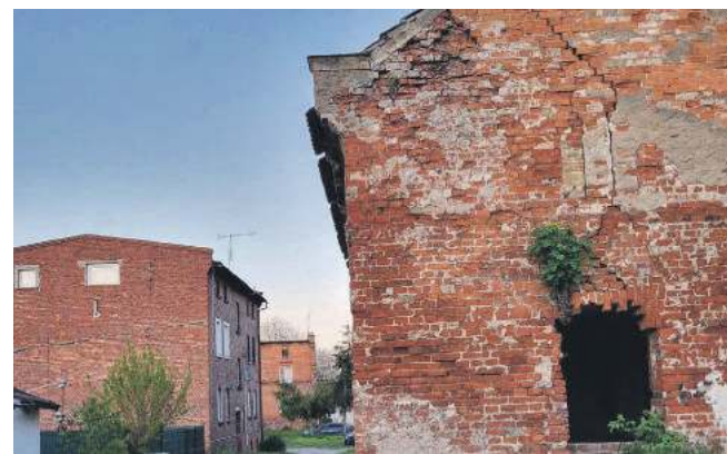
Stodoła przeznaczona jest do rozbioru. Widać na zdjęciu pęknięcie muru
