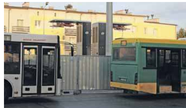
Na dworcu kolejowym w Tarnowskich Górach powstają dwie ładowarki pantografowe
