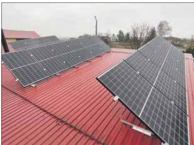
Firma Ekoserwis BP sp. z o.o. powstała w 1997 r. Jest to wykonawca instalacji fotowoltaicznych, czyli prywatnych elektrowni
