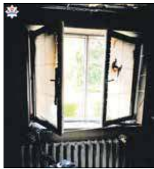
W wyniku pożaru częściowemu spaleni uległ dom
