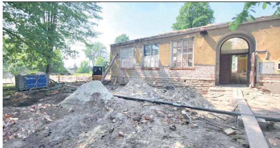
Z budynku dawnej szkoły w Osuchach zostało już niewiele
