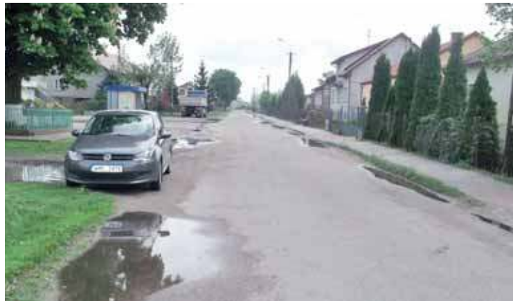
Droga przez Kowalewo przed modernizacją
