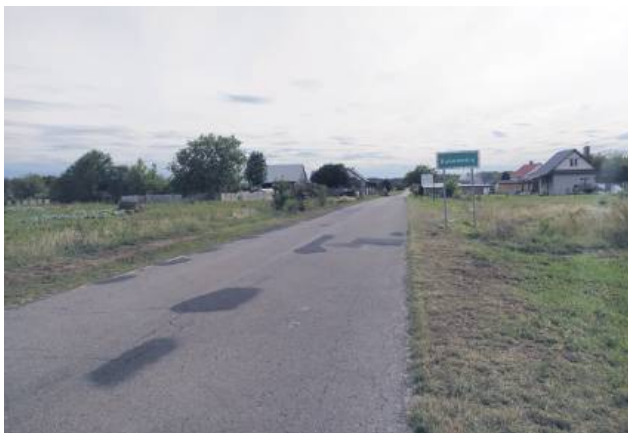
Droga jak najszybciej powinna przejść gruntowny remont.
