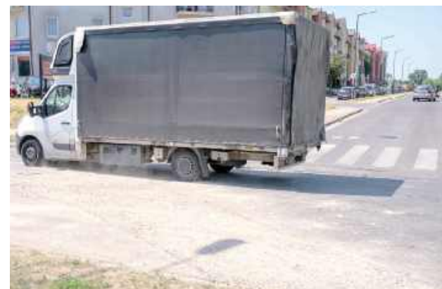
Zapadisko zostało tymczasowo załatane. Droga jest obecnie w pełni przejezdna w obu kierunkach, co pozwoliło uniknąć paraliżu komunikacyjnego miasta do czasu rozpoczęcia zasadniczego, bezinwazyjnego remontu
