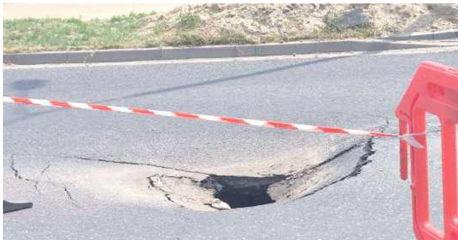
Powstałe zapadisko na ulicy Staszica w Łęcznej
