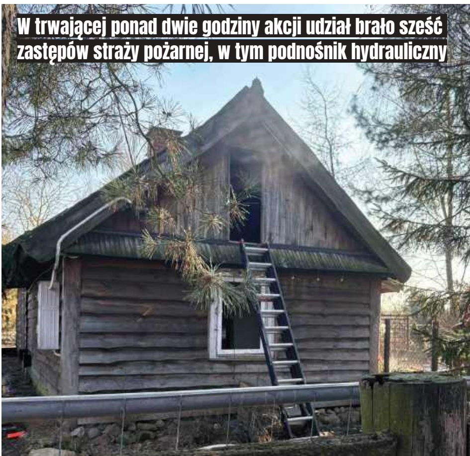
Ogień bardzo szybko objął drewnianą konstrukcję budynku
