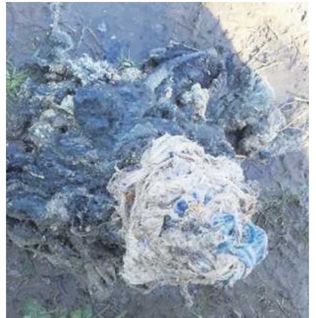
Na powyższych zdjęciach zilustrowano, co zostało wydobyte z pompy sieciowej przez pracowników kanalizacji w Przewornie
