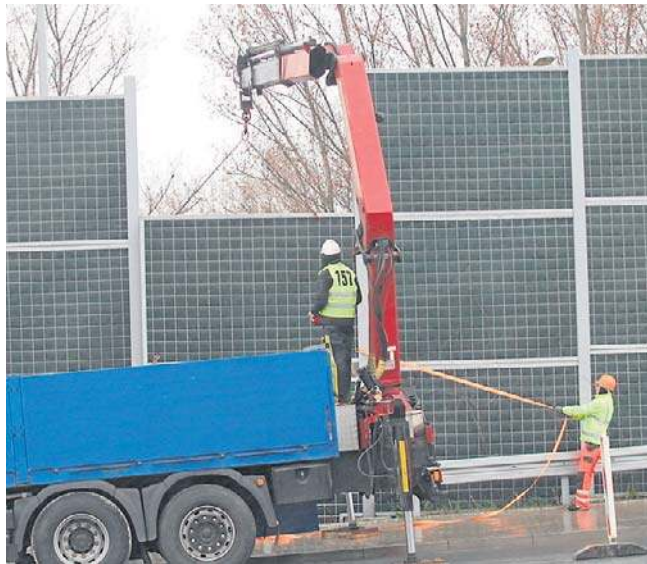
Według inwestora, ekrany mogą zostać zamontowane dopiero po zakończeniu inwestycji w Tyczynie
