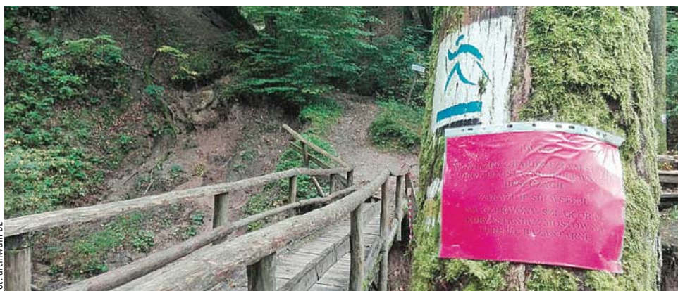
Ta ścieżka rowerowa została zniszczona podczas powodzi sprzed 3 lat
