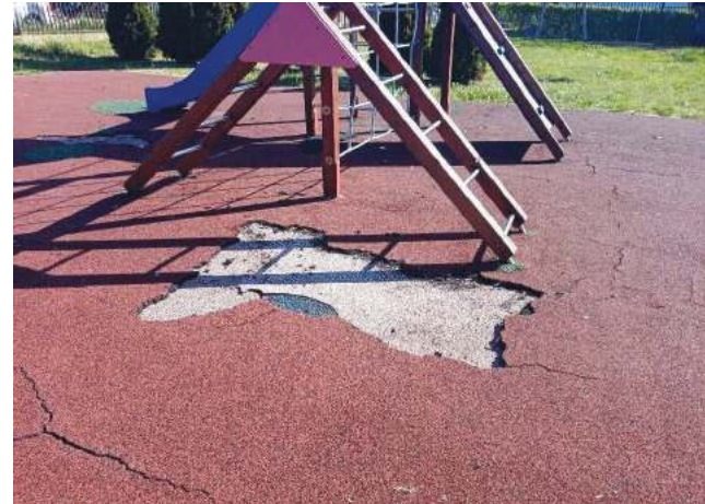
Nie da się ukryć, że plac zabaw przy ZS-P nr 3 potrzebuje remontu
