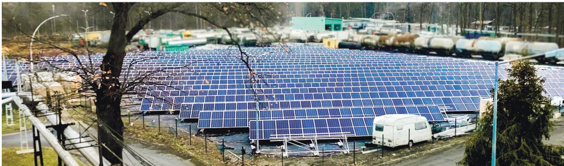
Jedna z kilku farm fotowoltaicznych zainstalowanych na terenie Lerg.
