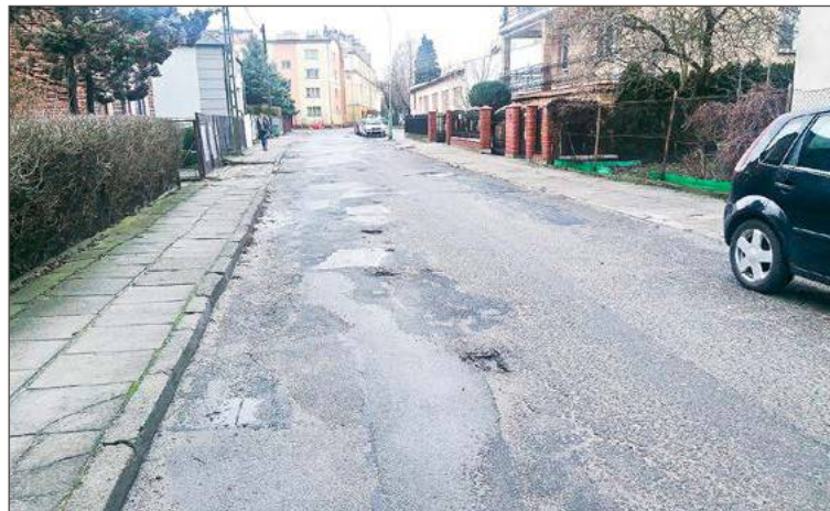
Ulica Gawrysia to jedna z bardziej zniszczonych w mieście.
