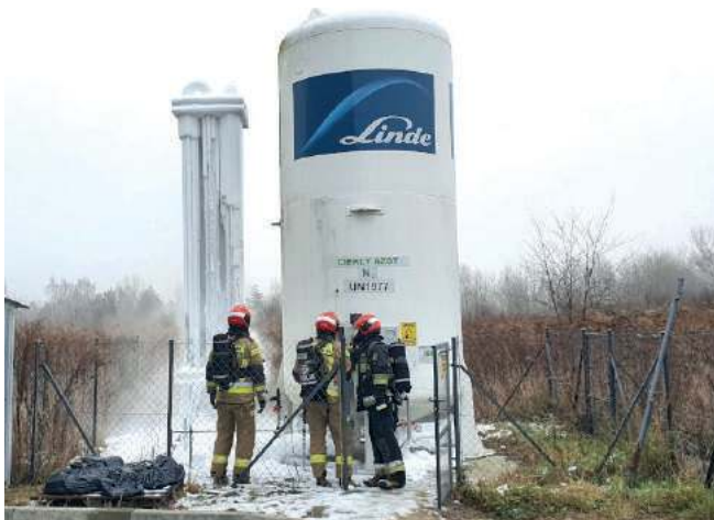
Zbiornik kontrolowali strażacy z Lubartowa i Lublina. Nieszczelności nie wykryli
