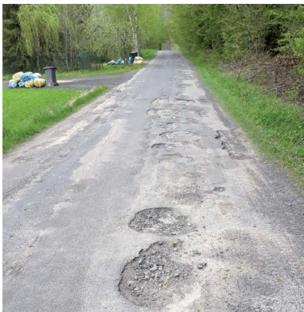
Droga jest w opłakanym stanie na całym dwukilometrowym odcinku, „ubytek na ubytku”, remonty cząstkowe nie pomagają! - alarmują mieszkańcy Nowego Radzica
