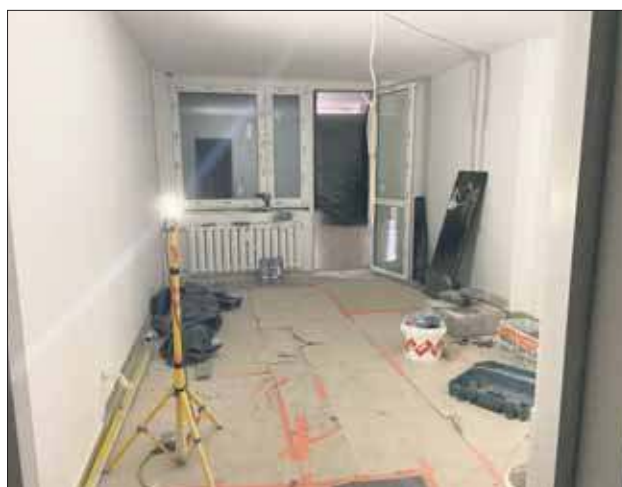
Części prac remontowych nie można wykonywać bez zgody spółdzielni
