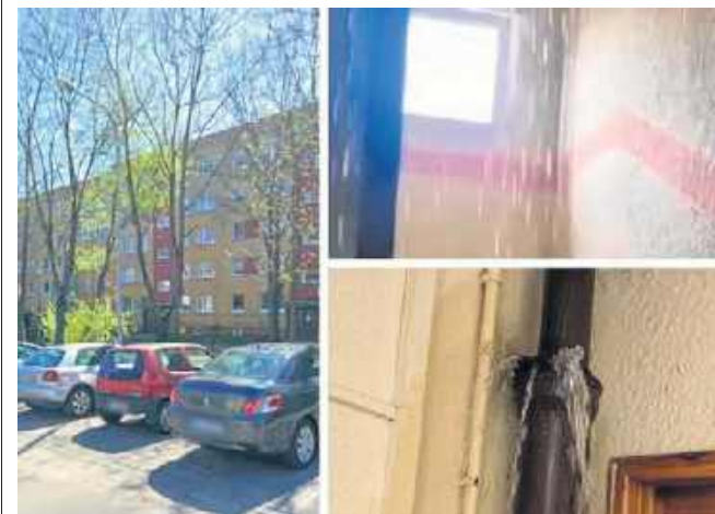
Po deszczu woda kolejny raz wdarła się do bloku w dzielnicy Północ
