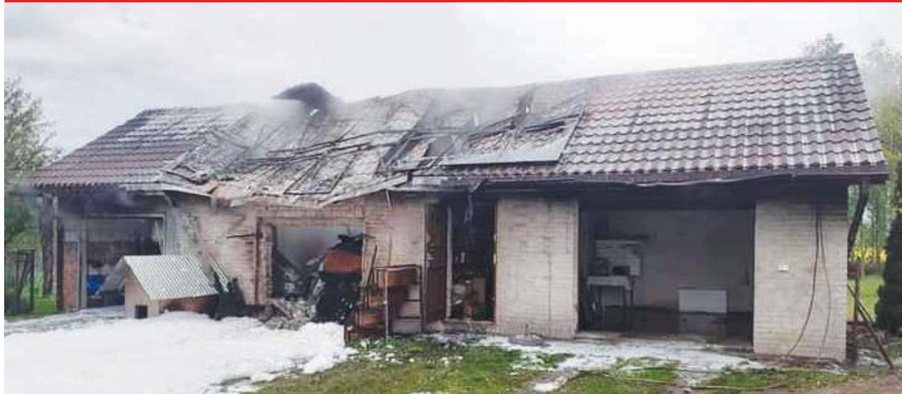
Pożar budynku gospodarczego w Przemiarowie z 19 maja. Zdjęcie z fb OSP Głódowo
