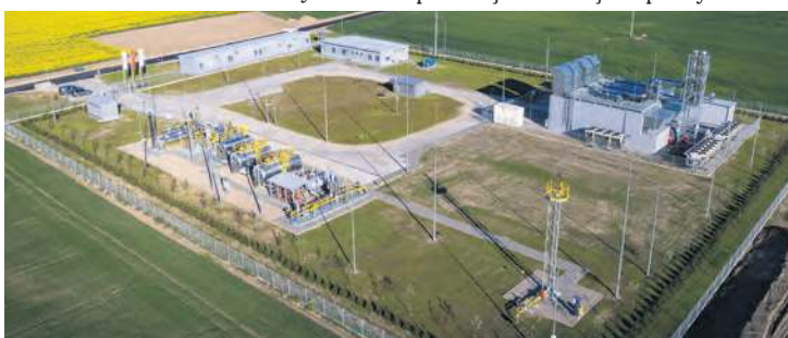
Elektrownie modułowe wybudowane przy złożach gazu w Bajerzu i w Sicinkach (gmina Kęsowo) wyglądają identycznie.
