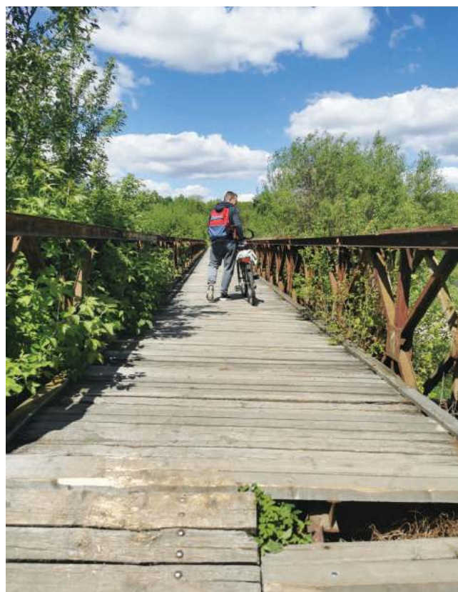
Ubytki w nawierzchni mogą grozić wypadkiem
