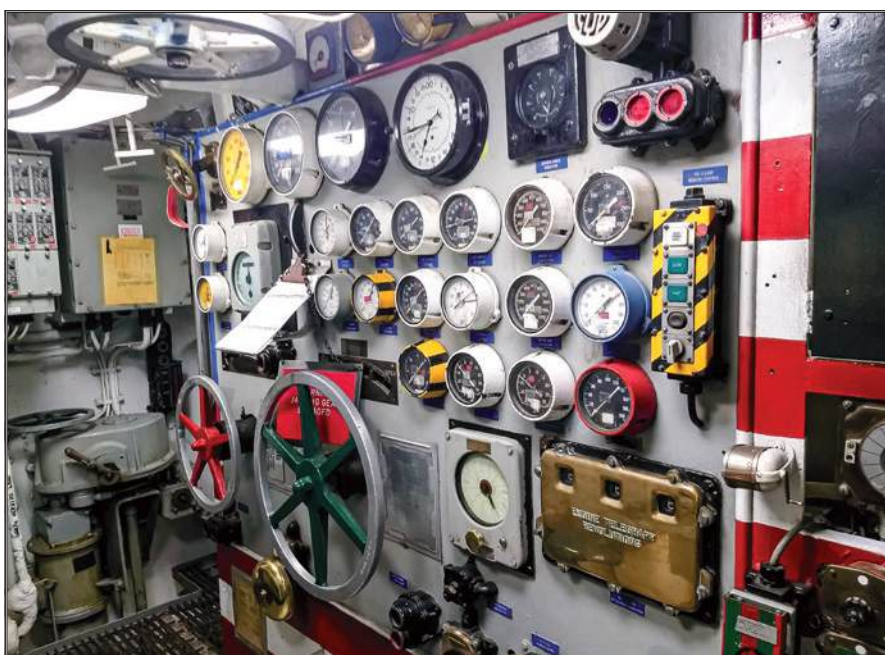
Rozbudowane układy pomiarowe i sterownicze panelu kontrolnego kotłowni w centrum sterowania siłownią pancernika USS New Jersey (BB-62).
