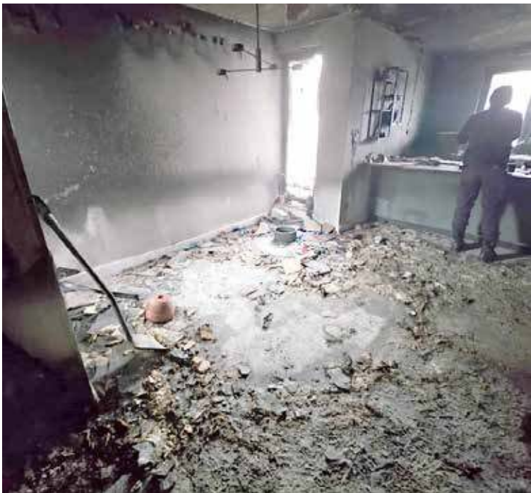
Zniszczenia są znaczne
