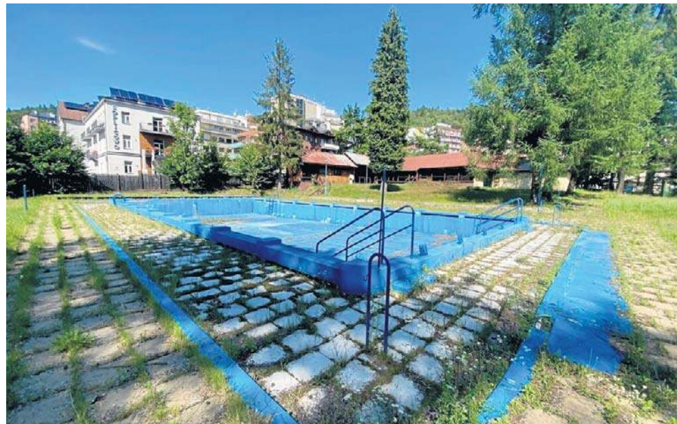
Basen po latach wyłączenia go z użytku jest w fatalnym stanie. Przeprowadzenie remontu obiektu jest kosztowne, a spółka uzdrowskowa nie ma pieniędzy na ten cel
