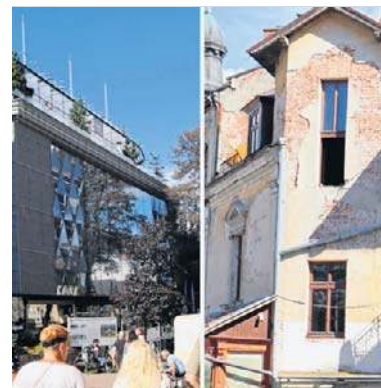
Wysoki polysk i odpadający tynk
