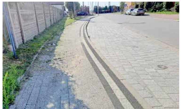
Chodnik w wielu miejscach zaczyna się zapadać (fot. Sołectwo Lubczyna)
