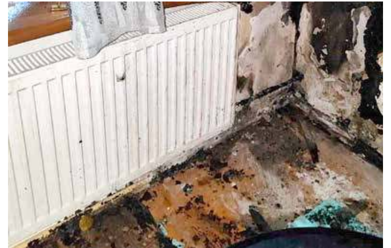
Uszkodzenia mieszkania są poważne (fot. zrzutka.pl)
