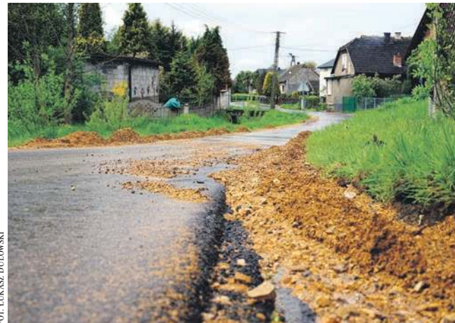
Wyremontowana ul. Jana Pawła II w Kwaczale po gwałtownych opadach deszczu
