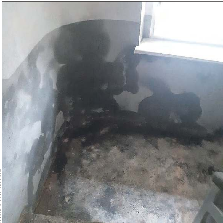
Dolna część klatki schodowej i tunel przejazdowy są zawilgocone
