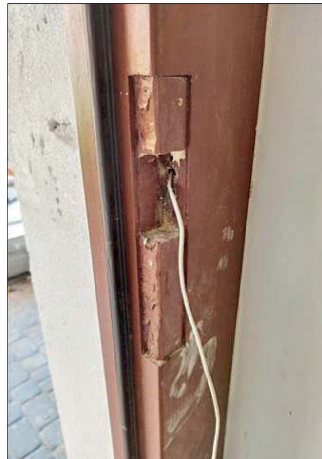
Kilka dni po zamontowaniu nowego domofonu, ktoś postanowił go zniszczyć. Został wyrwany elektrozaczep z wkładką i zamkiem.
