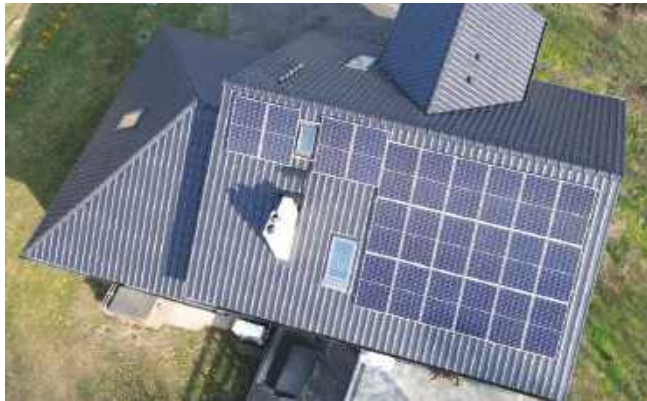
■ W ramach 106 nieprawidłowości wykrytych w inwestycjach przeprowadzonych w województwie śląskim, 9 umów zostało rozwiązane w subregionie zachodnim. FOTO: S.KAMCZYK
