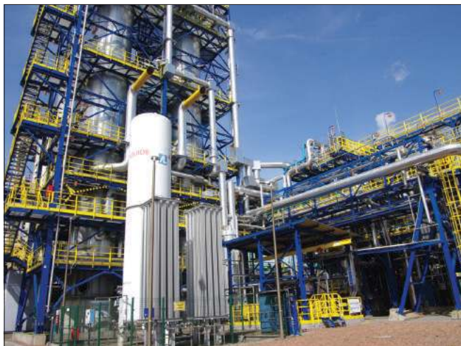
Obecnie w Koksowni Radlin działa instalacja KRAiC
