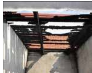
W wyniku pożaru częściowego spaleni uległo poszycie dachu wraz z jego drewnianą konstrukcją
