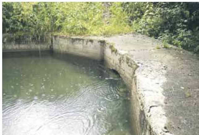
To miejsce lepiej omijać. Jest niebezpieczne i groźne nie tylko dla zwierząt, ale i dla ludzi. Tauron obiecuje, że zabezpieczy wlot do kanału.
