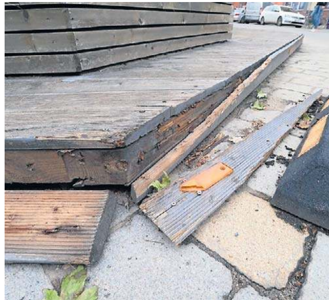
Drewniane konstrukcje się sypią. Dosłownie
