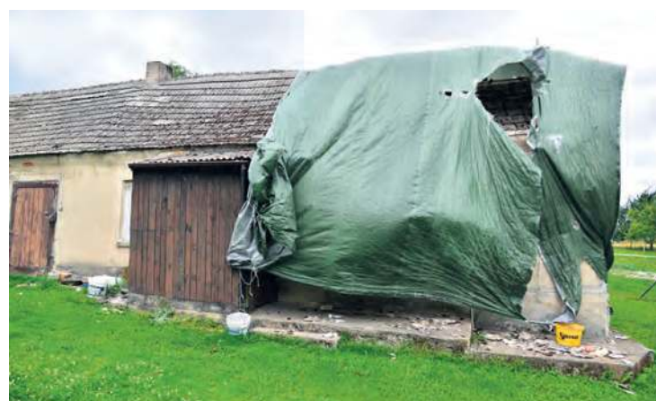
Zawaleniu uległ dwuspadowy dach nad częścią mieszkalną budynku.
