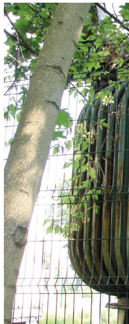
Rdzewiejący transformator z 1936 r. i tablica znamionowa
