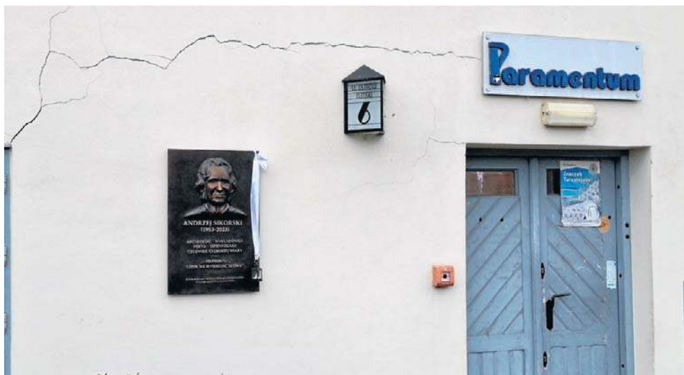
Na zabytkowej kanonii przy ul. Ostrów Tumski 6 w Poznaniu widoczne są spękania, które od miesięcy budziły pytania o przyczynę uszkodzeń
