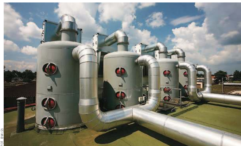
W takich czterech wieżach odbywa się napowietrzanie wody surowej
