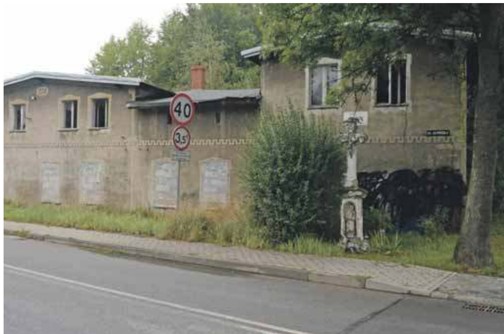
Zabytkowy krzyż widnieje w Gminnej Ewidencji Zabytków, gdzie czas jego powstania określono na połowę XIX wieku. Stojący za nim budynek datowany jest na początek XX wieku, został rozbudowany w 1938 r. Cała nieruchomość popada w ruinę
