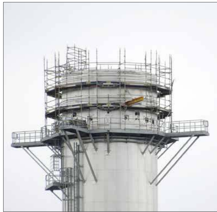
Na kominach obu bloków gazowych montowane są tak zwane tłumiki
