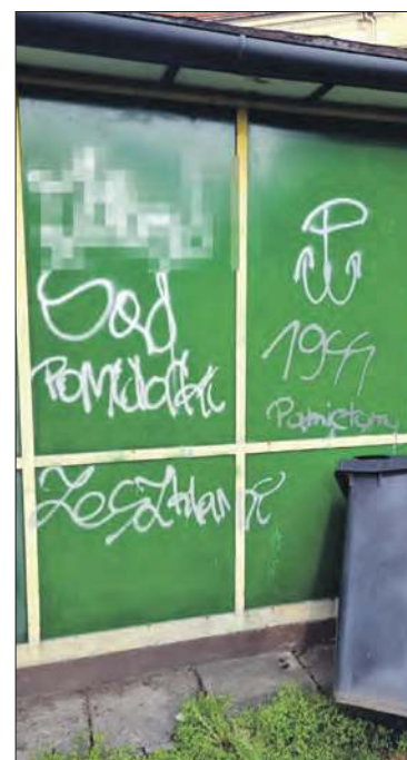
W tym miejscu sprawca też coś po sobie pozostawił
