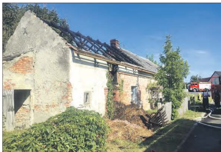
Budynek po ugaszeniu pożaru
