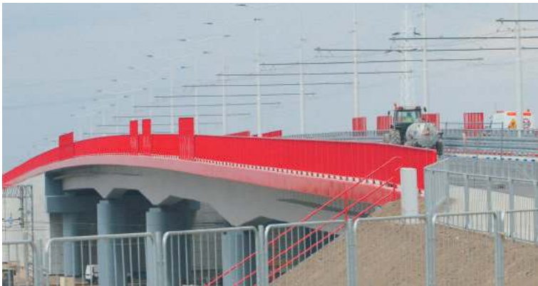
Nowe wiadukty na Grygowej stoją gotowe od maja, a do dziś nie zostały dopuszczone do użytkowania
