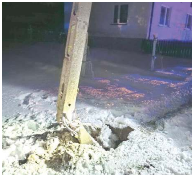
Siła uderzenia była tak duża, że betonowa konstrukcja słupa złamała się. Z uwagi na poważne uszkodzenia wezwane zostało pogotowie energetyczne
