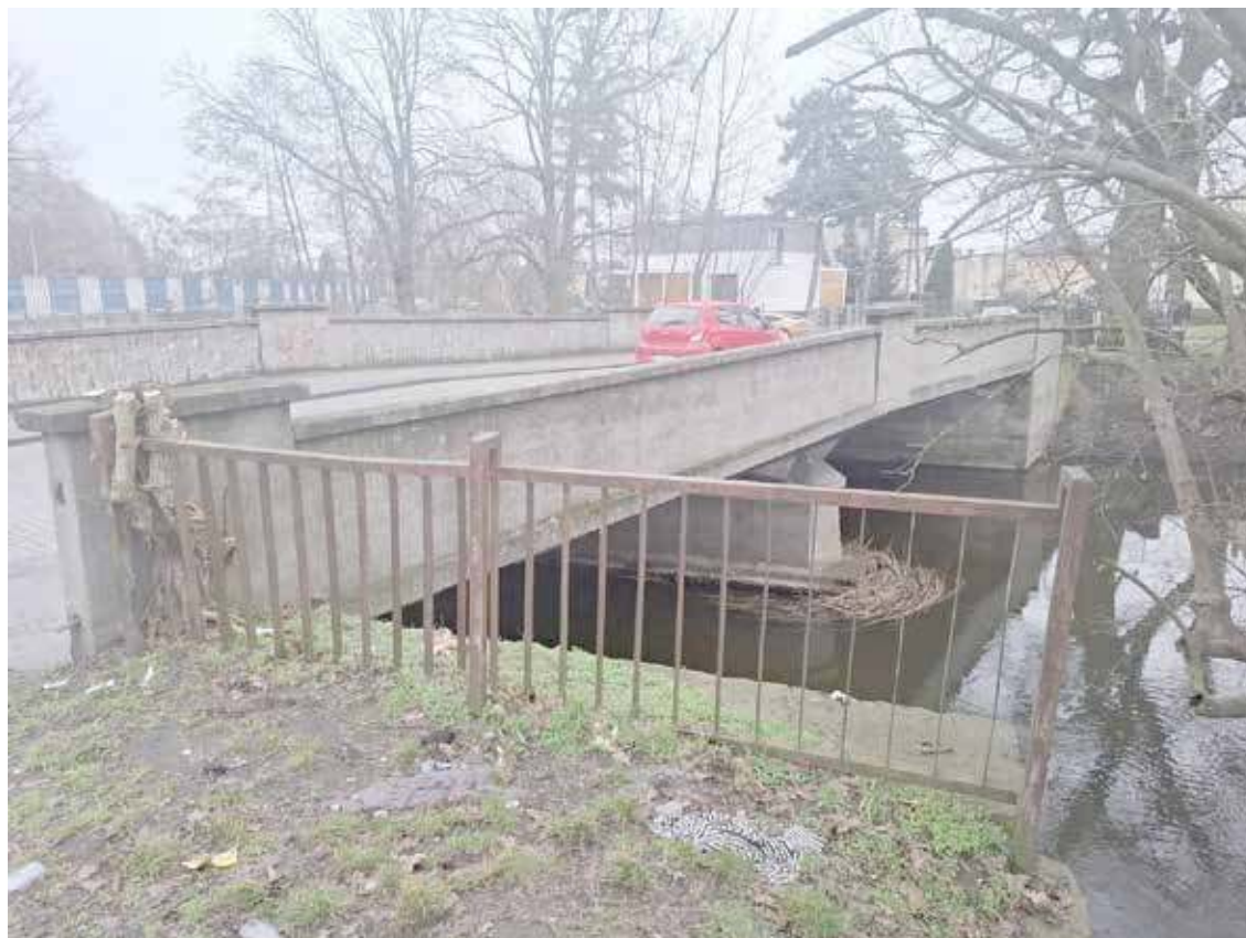
Ta barierka wymaga naprawy. Jest skorodowana.jpg
