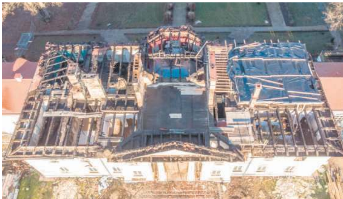
Zdjęcie dachu pałacu wykonane 2 grudnia br.
