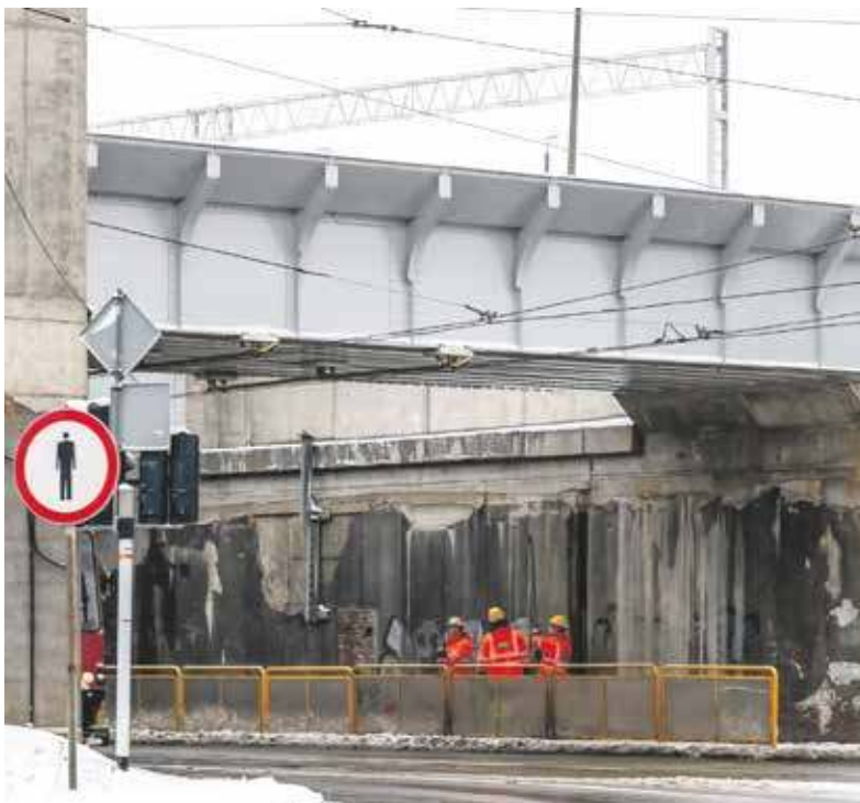
Szarobure ściany wiaduktu doczekają się odnowy
